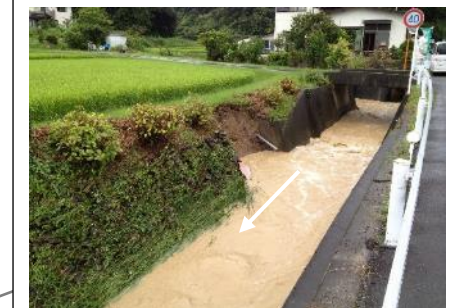
平成24年8月14日降雨による護岸損傷状況
