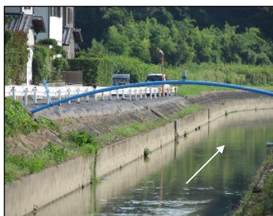
〔対策実施前〕堤防高が低く溢水
