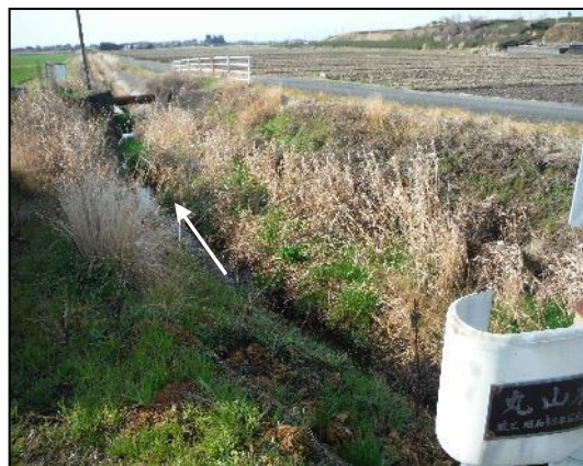
〔対策実施前〕堆積土、雑草の繁茂
