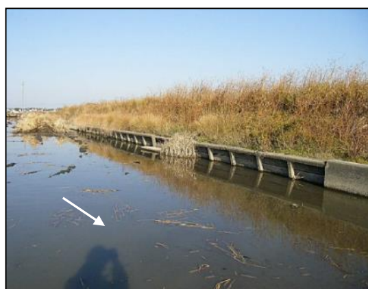
〔対策実施前〕水路の老朽化
