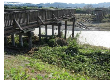
橋梁流失(新屋橋)
