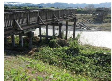
橋梁流失(新屋橋)
