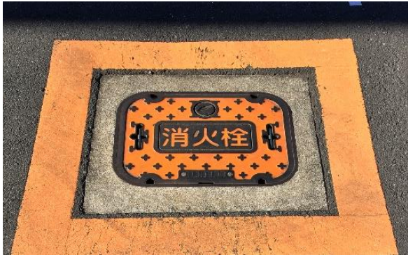
四角型消火栓
