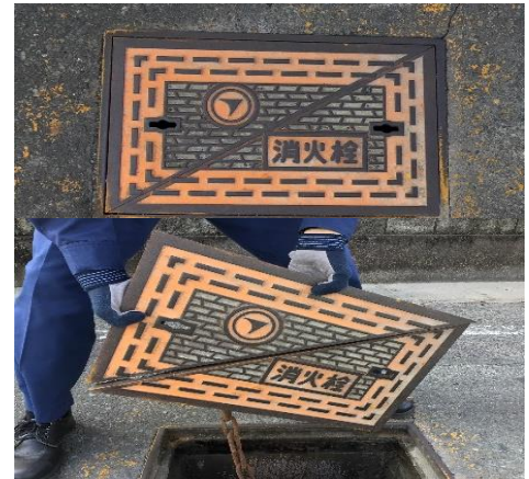
四角型消火栓（割蓋）
