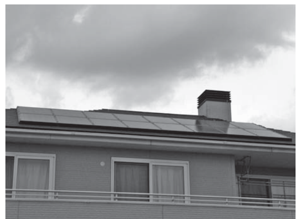
太陽光発電システム
