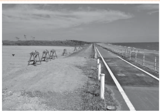
早期整備が望まれる防潮堤
