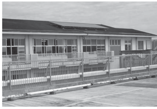
浅羽南小学校の屋根に設置された太陽光パネル
