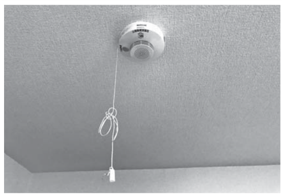
住宅用火災警報器の設置状況
