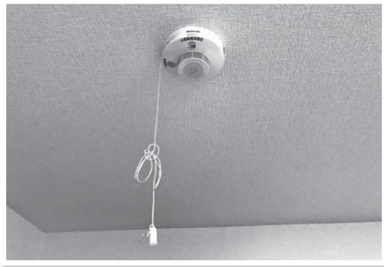
住宅用火災警報器の設置状況
