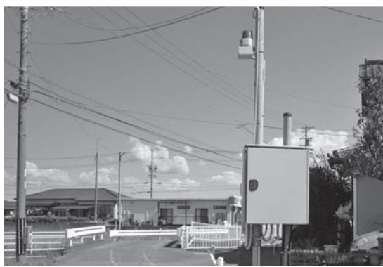
久津部西地区に設置された浸水センサー
