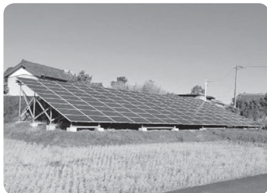
太陽光発電システム
