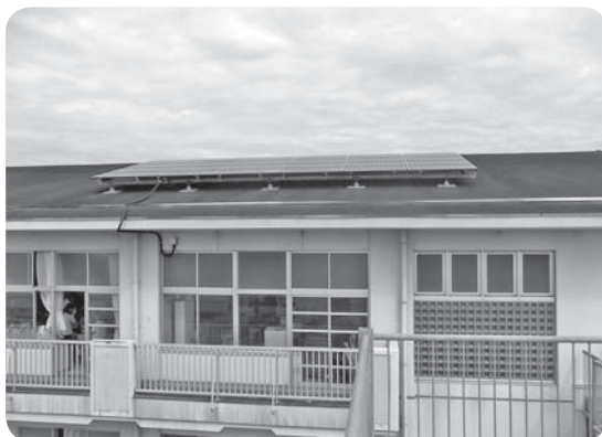
浅羽南小学校の屋根に設置された太陽光パネル
