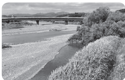
水の流れが滞った山梨用水取水口付近
