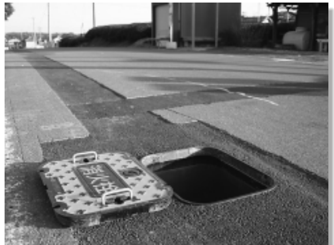
簡易水道統合整備事業により設置された消火栓
