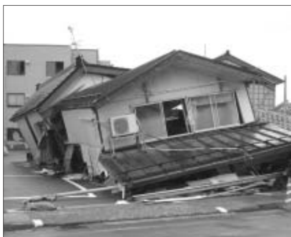
新潟県中越沖地震で倒壊した木造家屋
