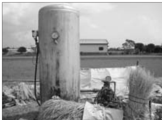
地下水汲み上げポンプ(井戸)
