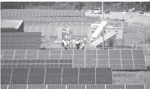
山梨県北杜市の太陽光発電所
