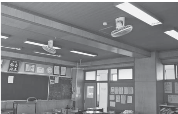
教室の天井に設置された扇風機
