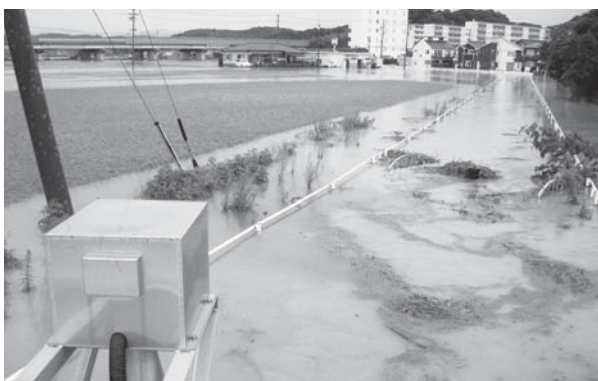
大谷川に設置されている水位計
