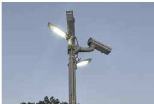
道路及び公園照明灯
