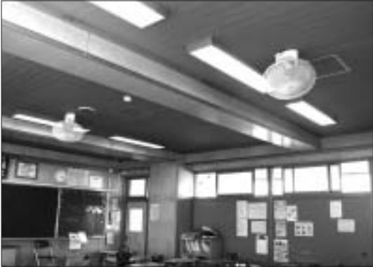
扇風機が設置されている袋井中学校の教室
