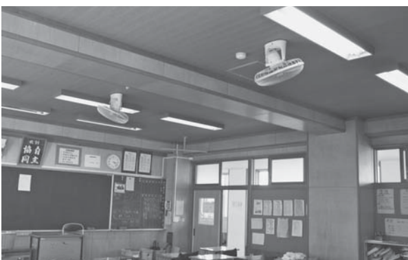
教室の天井に設置された扇風機
