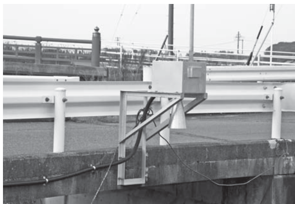
現在設置されている河川水位計
