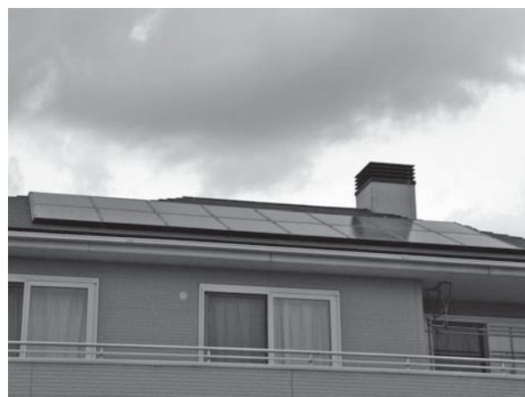
太陽光発電システム
