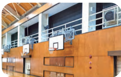
体育館空調設備の一例
