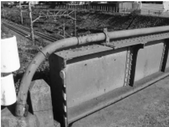
弾痕が残る通称「陸橋」(高尾跨線橋)の側板
