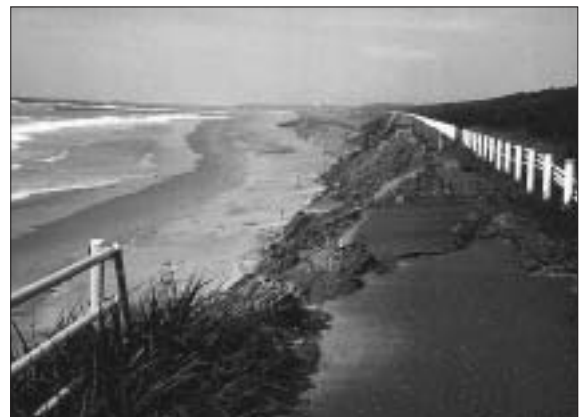
海岸浸食と台風で堤防が崩れた浅羽海岸(昨年9月撮影)
