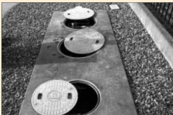
合併処理浄化槽
