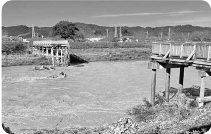
台風15号豪雨により落橋した「新屋橋」
