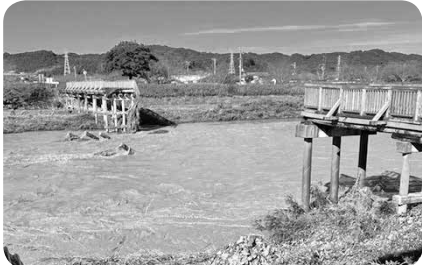
台風15号豪雨により落橋した「新屋橋」
