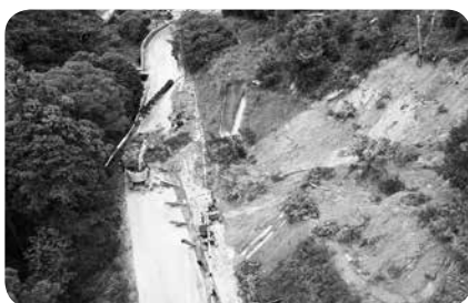
市道大谷幕ヶ谷線法面崩落の様子
