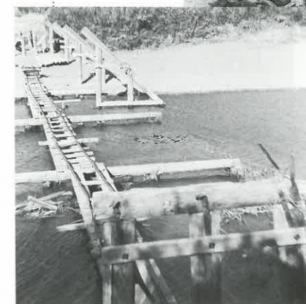
8月の集中豪雨で流失した二瀬東橋
