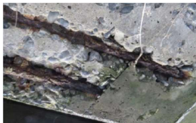
床版の鉄筋露出
