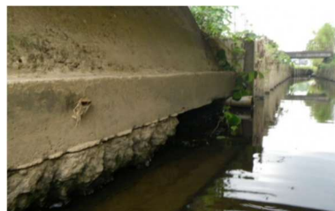
下部工の洗掘
