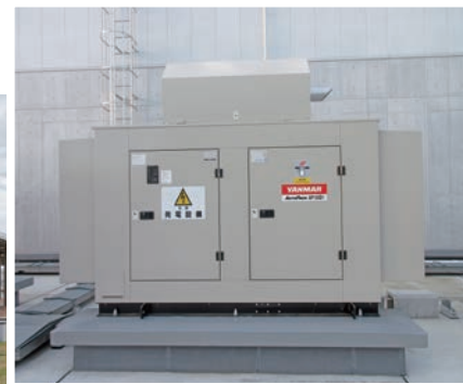
非常用発電設備
