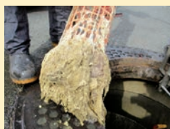
紙類が詰まって故障したマンホールポンプ
