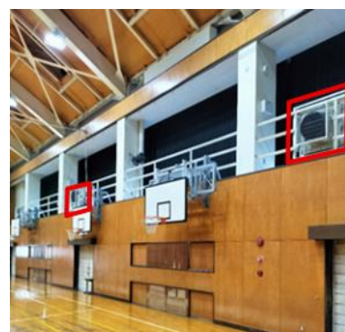
【空調設備設置イメージ】
