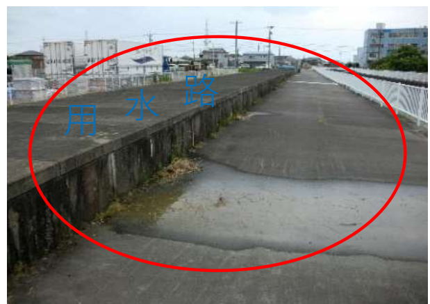
用水路からの漏水
