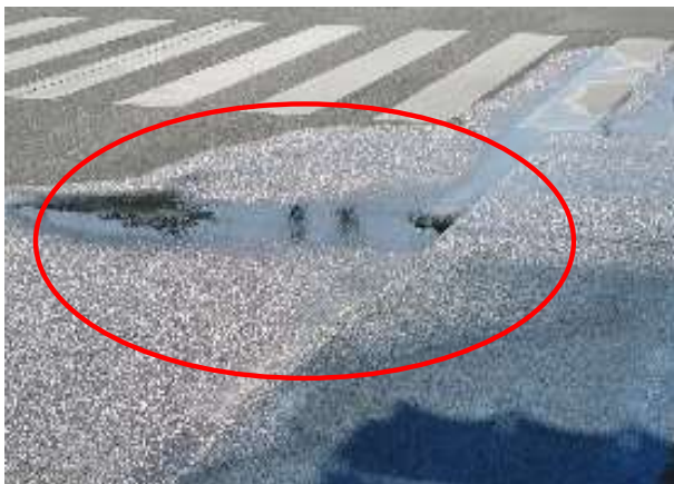
地下に埋設されているパイプライン の漏水・路面一部陥没
