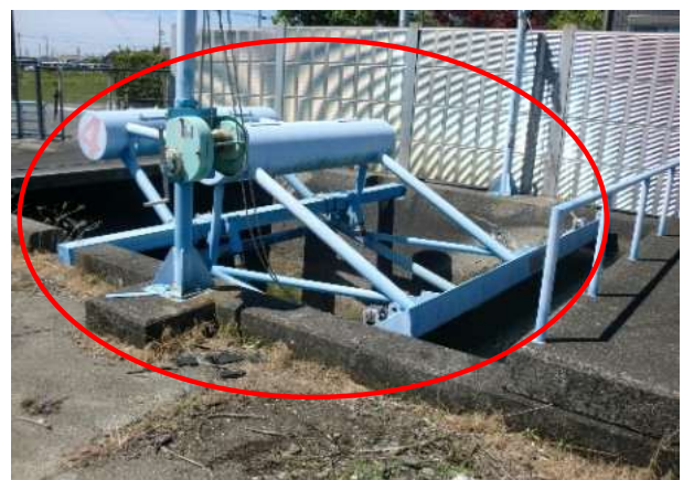
水位を上げる施設の老朽化
