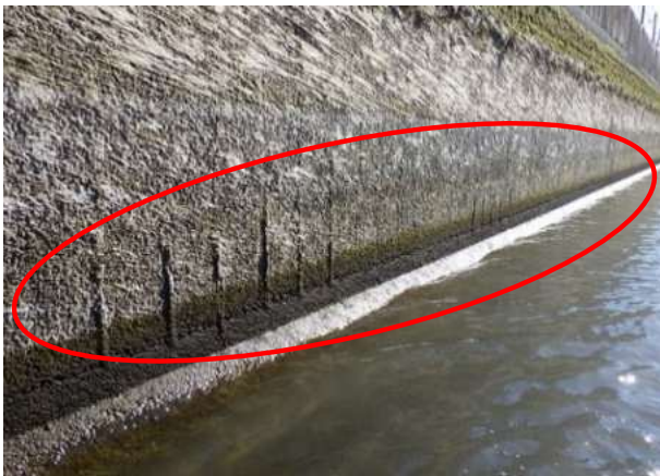
用水路の老朽化（鉄筋露出）
