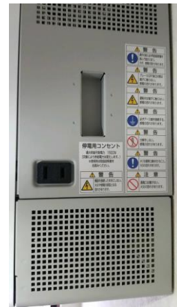
パワコン側面に ある停電用 コンセント
