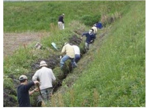
多面的機能支払交付金事業による水路の整備の様子（三川地区）
