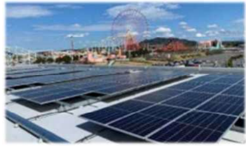
▼建物屋上に設置されたソーラー (出典：国交省 HP)
