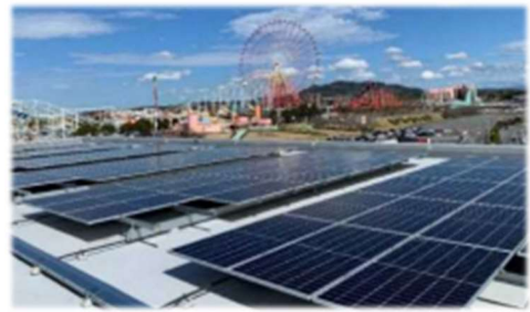
▼建物屋上に設置されたソーラー (出典：国交省 HP)
