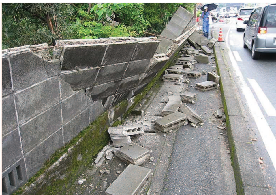
平成28年4月16日の熊本地震によるブロック塀の倒壊（熊本県上益城郡益城町） ※縦の鉄筋がブロックの中に入っていないことが原因により、ブロック塀が転倒した。
