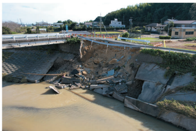
令和4年9月 台風15号 明治橋
