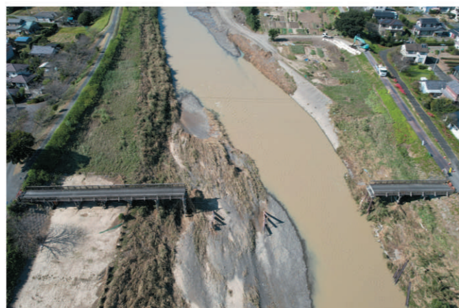
令和4年9月 台風15号 新屋橋
