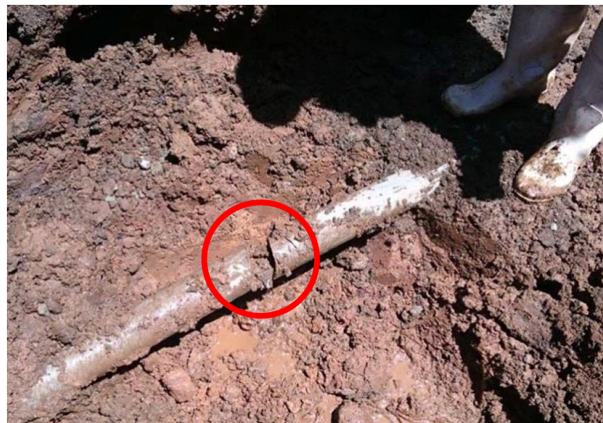
写真2 地震による管体被害(破損) 塩化ビニル管 口径75mm
