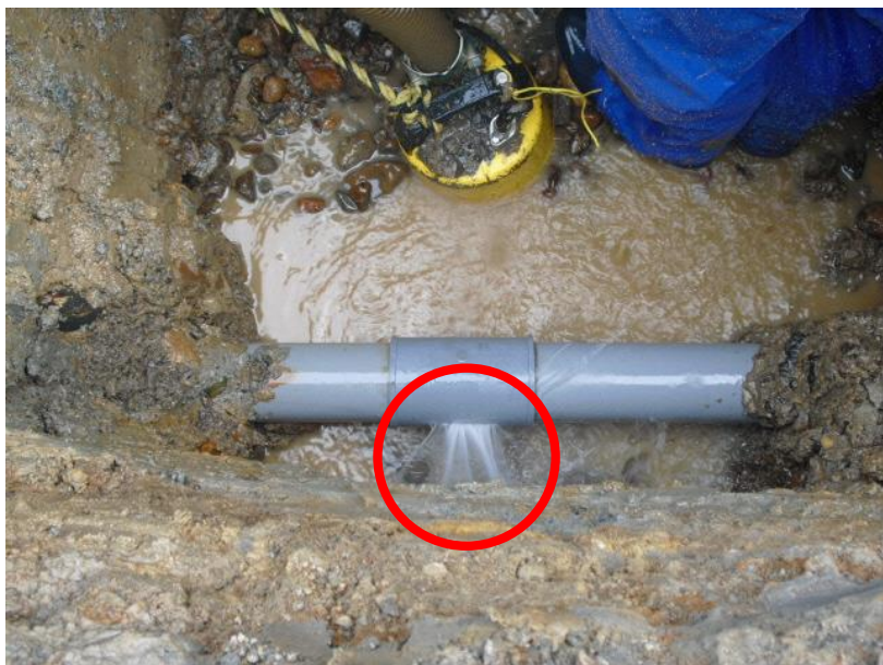
写真1 老朽化による漏水事故(市内某所) 塩化ビニル管 口径75mm
