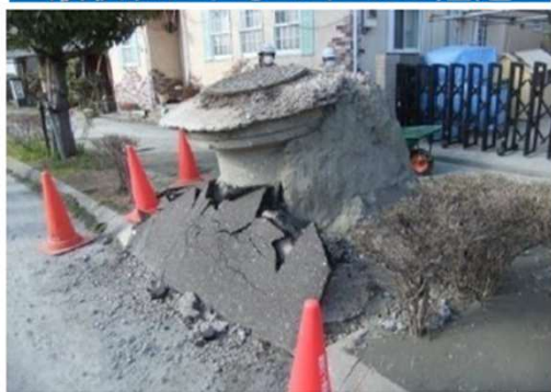
液状化によるマンホールの隆起
