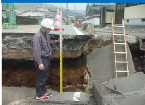
断層ズレによる下水管の破断
