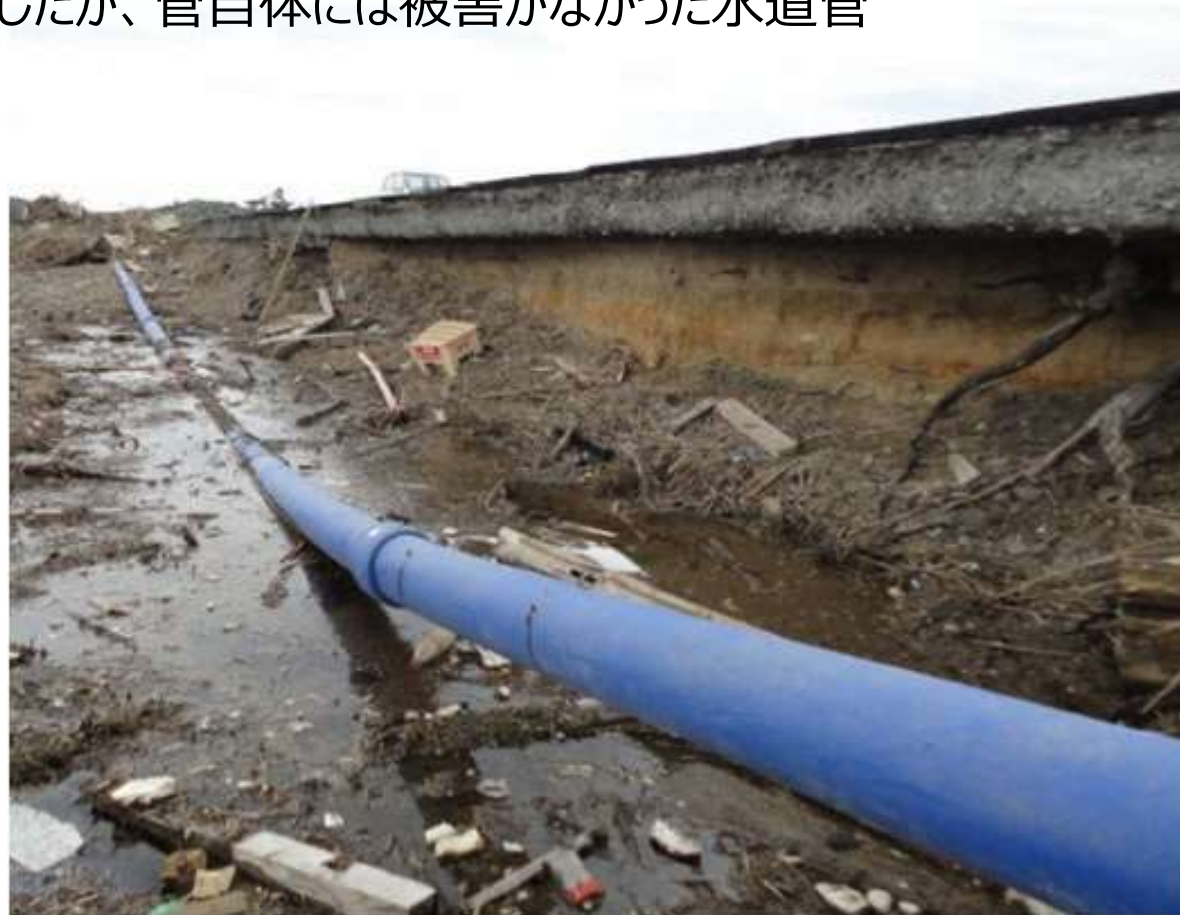
写真3 津波による道路の洗掘により管体露出 水道配水用ポリエチレン管 口径150mm
