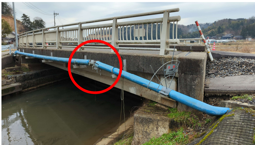
写真1 能登半島地震による水道管の破損
