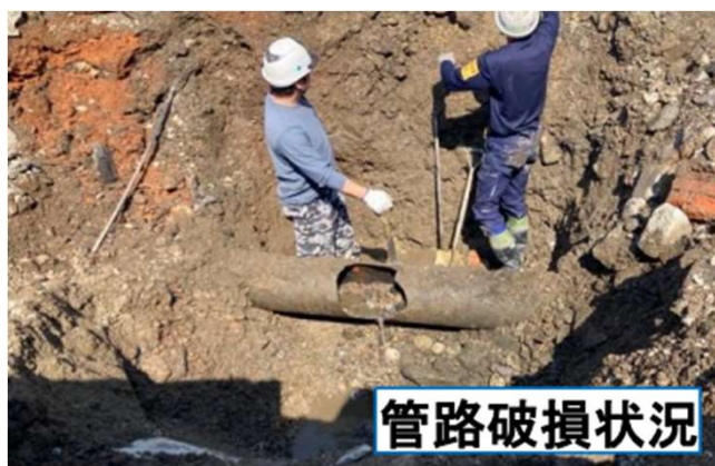
写真1 京都市下京区における水道管漏水事故 鋳鉄管 口径300mm (令和7年4月)
