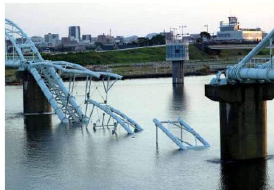
写真2 和歌山市における老朽化(腐食)による水管橋落下事故 鋼管 口径900mm (令和3年10月)
