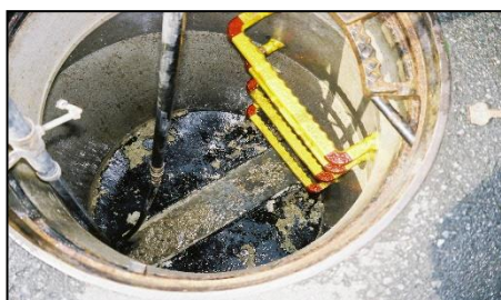
通常時のマンホール
