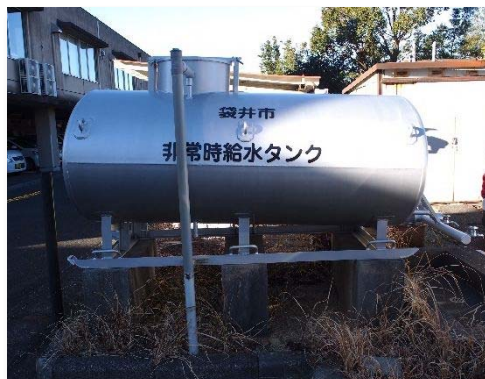
«非常用給水タンク：袋井市役所»
