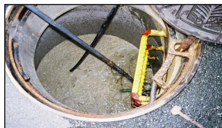
油で詰まったマンホール
