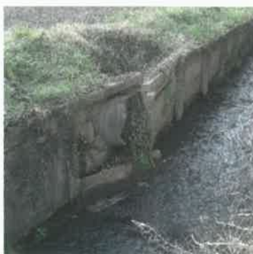
水路の割れ・漏水
